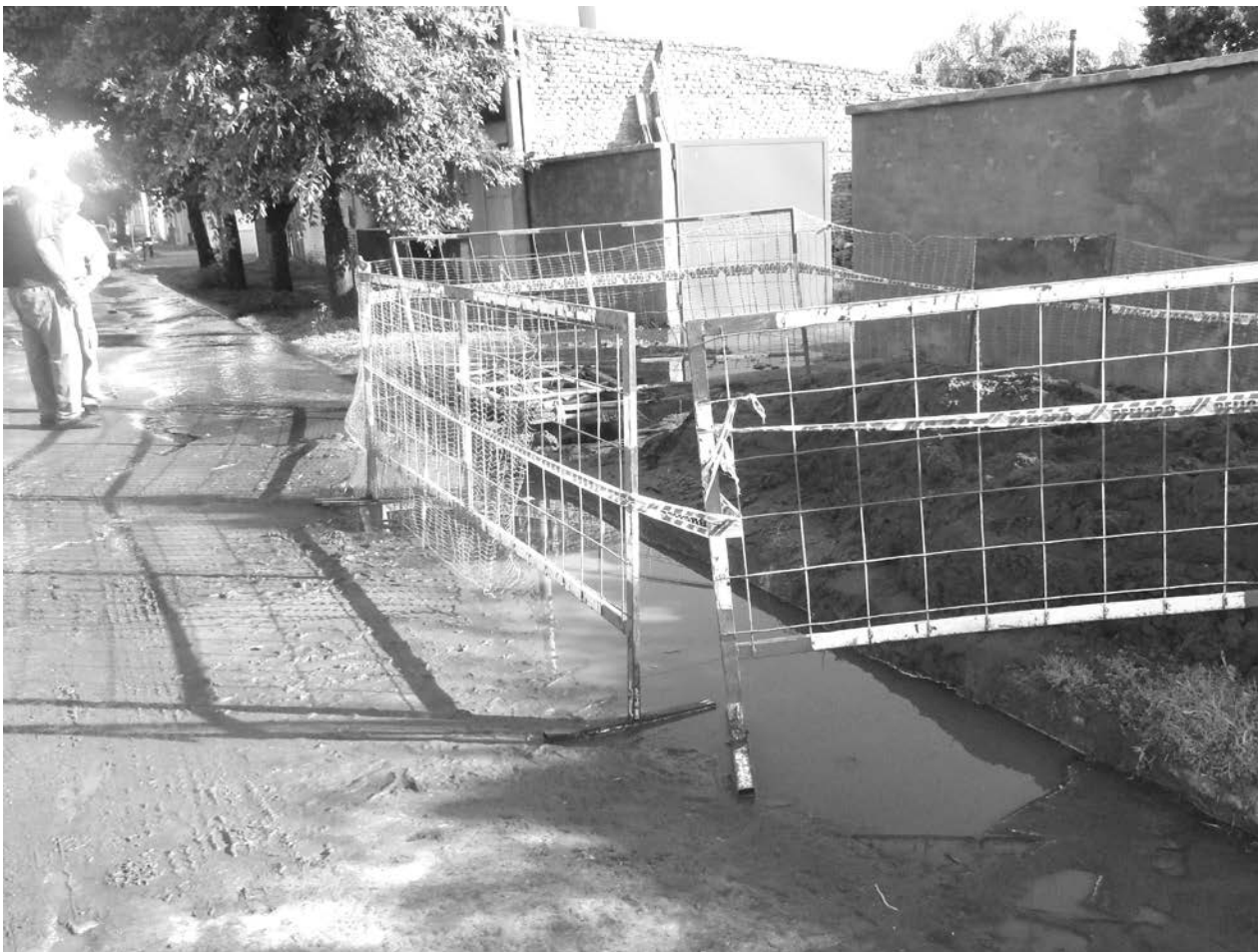
La rotura del caño produjo serios inconvenientes en el suministro de agua de red.
